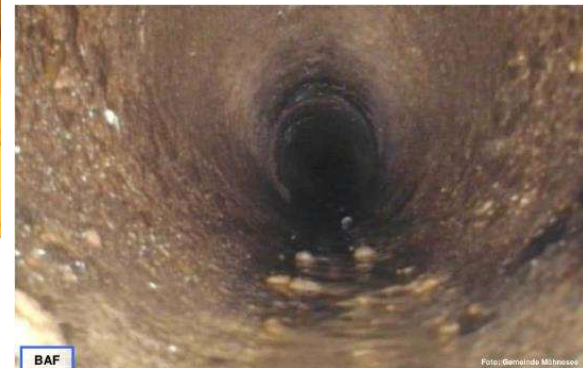
Innenkorrosion, Bewehrung sichtbar
